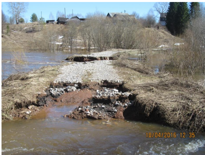
Рис. 8. Размыв автодороги ст. Просница – с. Волма в Кирово-Чепецком районе
