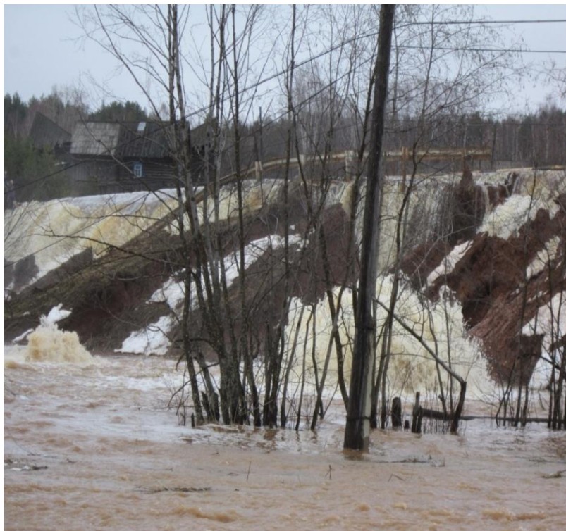
Рис.4. Перелив воды через дамбу в с. Верхолемье Унинского района
